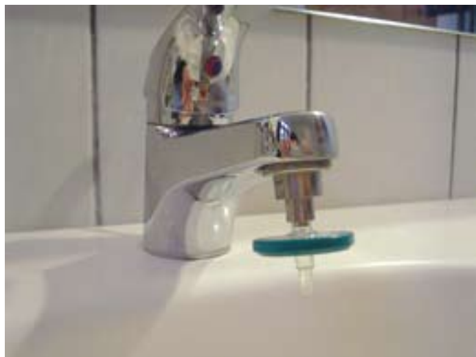
Haneadapter med filter monteret på vandarmatur.
